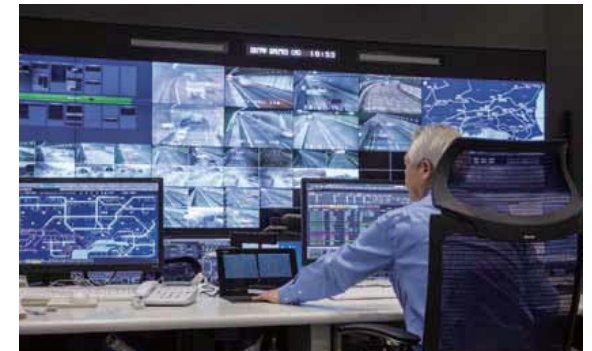
関東支社新道路管制センター(施設制御部門)
