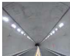
LEDトンネル照明
