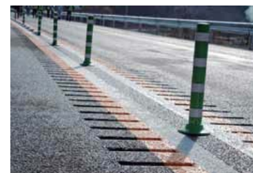
凹凸レーンマーク(暫定二車線区間)
