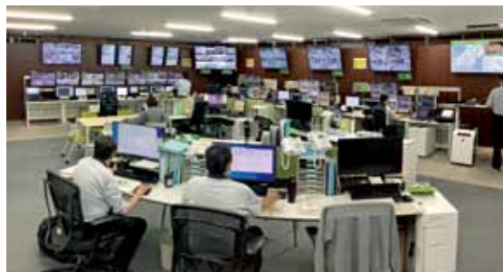
料金所を遠隔対応するオペレーションセンター
