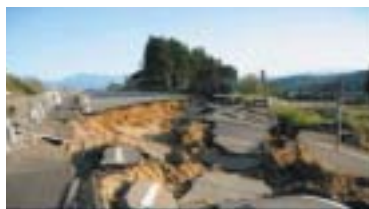
被災直後の状況
