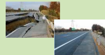
東日本大震災で被災した高速道路(常盤道)
