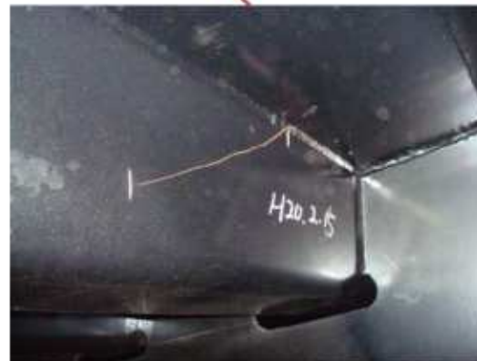
16年後 : 詳細調査(Uリブき裂)
