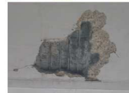
34年後 : 浮き・はく離・鉄筋腐食
