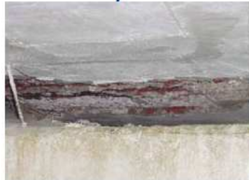
30年後 : 桁の鉄筋腐食
