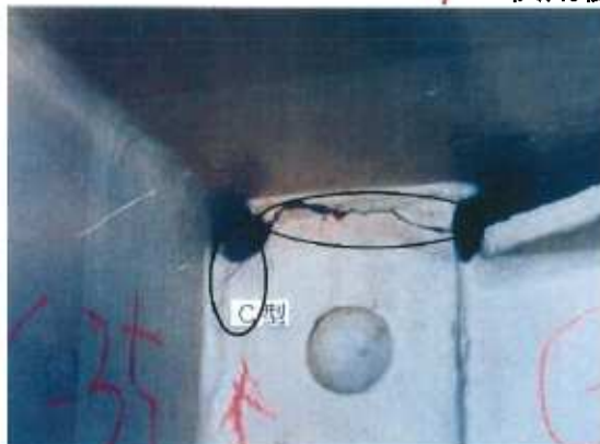
15年後 : 対傾構取付け部のき裂
