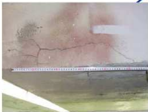
30年後 : 桁のひび割れ
