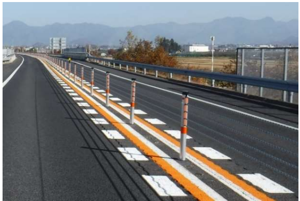
・ワイヤロープ設置区間における効果 設置後の正面衝突死亡事故 0件 (H29～R5年度)
