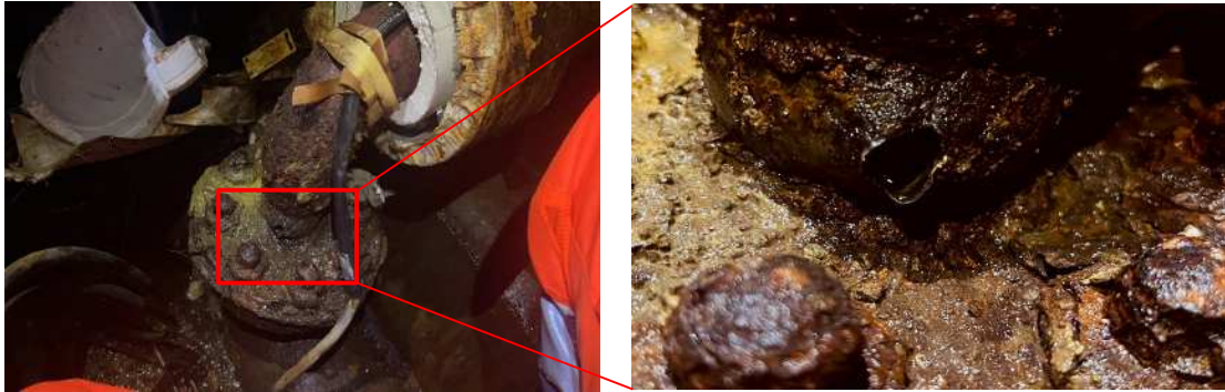
トンネル非常用設備(配管)損傷状況
