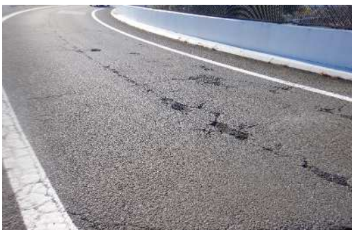
路面損傷状況
