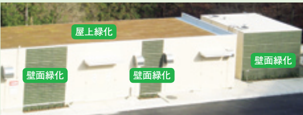
電気室の屋上・壁面緑化(北関東道)
