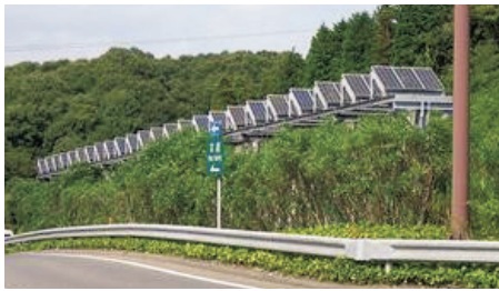
館山道 市原SA （太陽光発電：お手洗い照明に利用）
