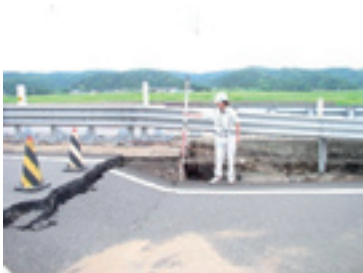
被災直後の状況
