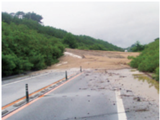
土砂流出の状況
