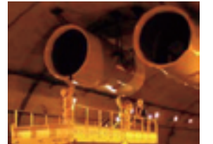
トンネル換気設備
