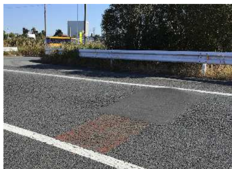
舗装損傷状況
