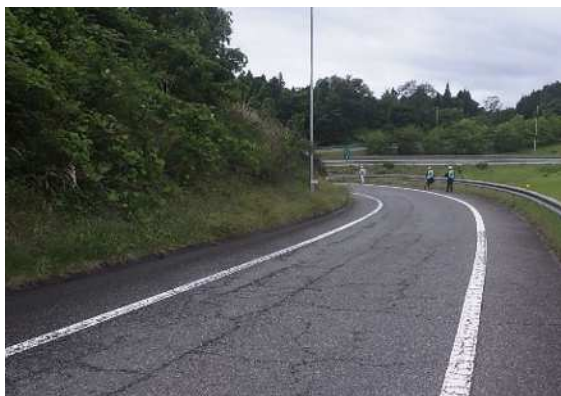
舗装損傷写真
