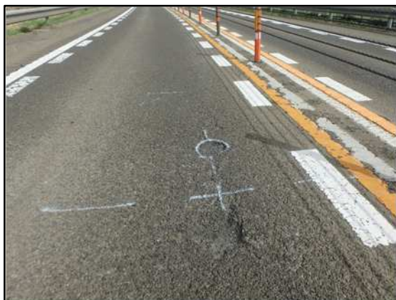
舗装損傷写真
