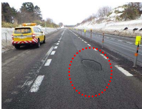
<舗装損傷状況>
