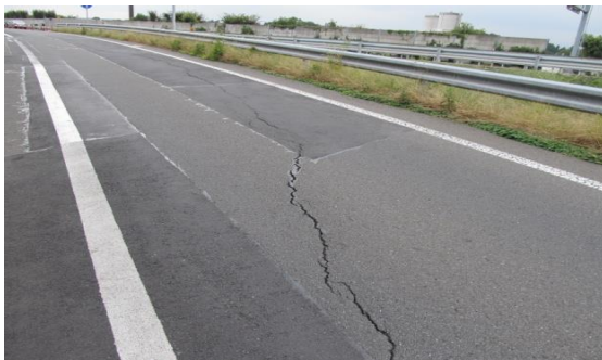
狭山日高 IC 現況舗装状況
