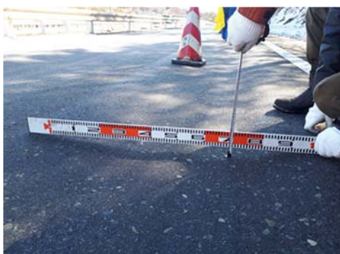
路面の損傷状況
