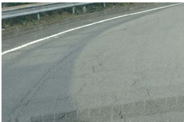
舗装劣化状況写真
