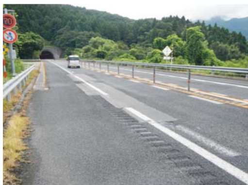
舗装路面の状況（安田IC～三川IC間）
