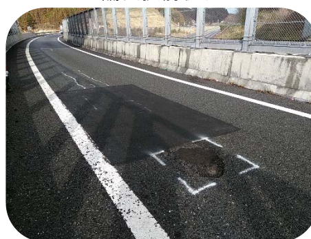
舗装損傷状況
