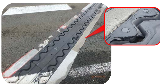
伸縮装置損傷状況
