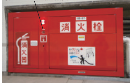
押しボタン式通報装置
