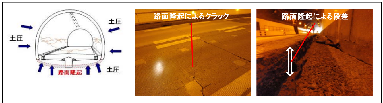
図-8 地盤材料の劣化によるトンネル内空の変状
