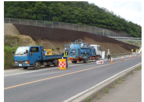
【参考】種吹付設備
