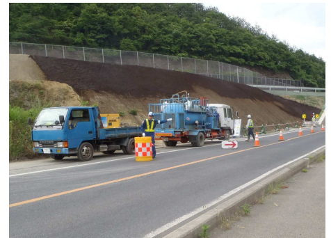
【参考】種吹付設備
