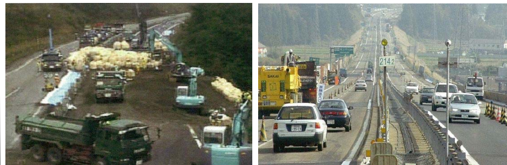
被災区間が4車線構造であったことの効果 (復旧ヤード確保) (通行帯確保)
