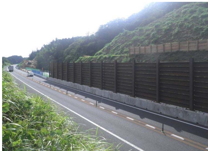
落石防護柵等による落石対策
