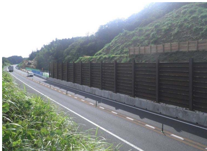
落石防護柵等による落石対策
