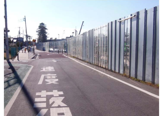
仮囲い(交差点の安全、防犯を考慮し部分的に透明板を設置)
