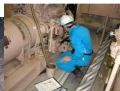
《受配電設備の点検》
