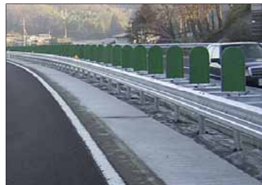
《強化型中分防護柵（整備後）》
