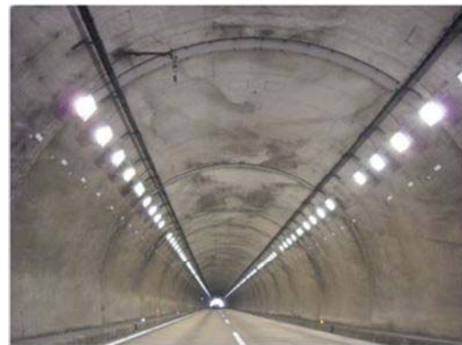
《蛍光灯照明》 上信越道 小諸トンネル
