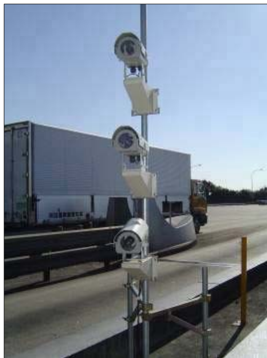
《不正通行対策用監視カメラ》
