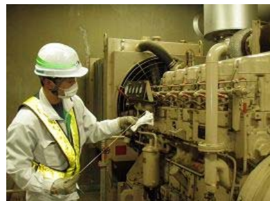
《自家発電設備の点検》関越自動車道 所沢IC
