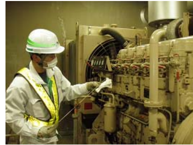
(施設)自家発電設備の点検
