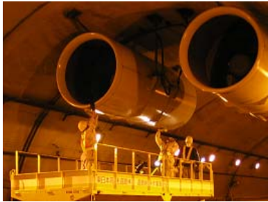
(施設)トンネル換気設備の点検
