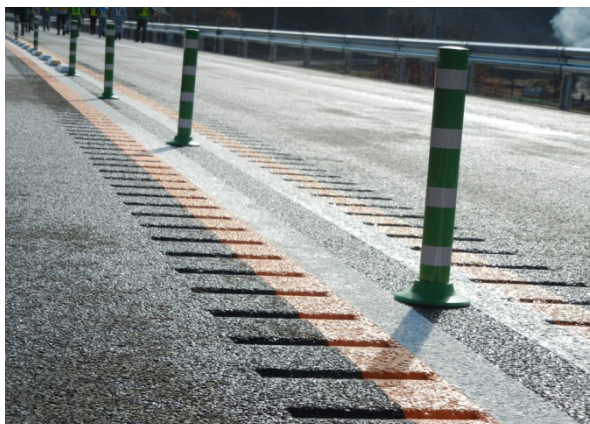
暫定2車線区間の凹凸型路面標示 (平成26年度約27km施工(上下計))
