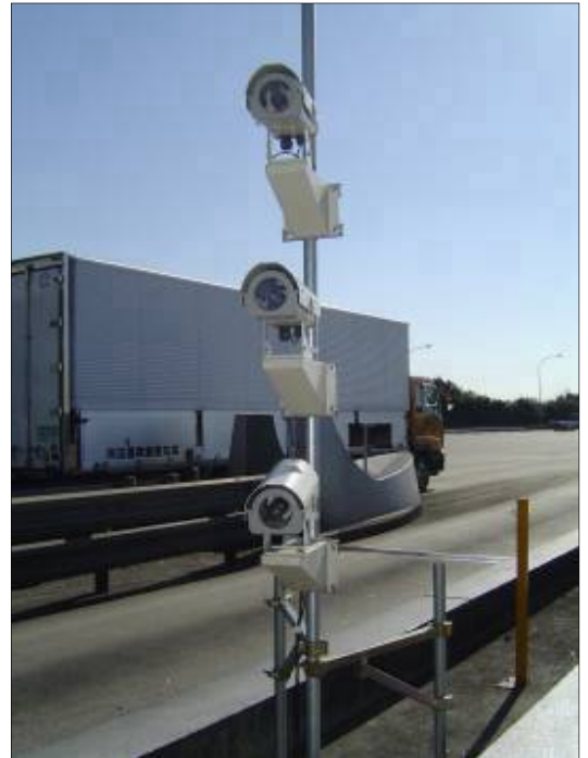
(不正通行監視カメラ)
