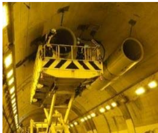
【(施設)トンネル換気設備の点検】
