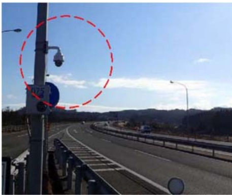
▲ 監視カメラの設置状況
