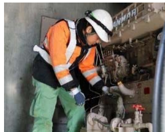
【(施設)受配電設備の点検】
