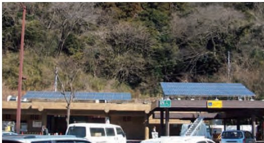
お手洗い照明等に利用している太陽光発電10kW (横浜横須賀道路 横須賀PA) ※高速道路関連社会貢献協議会の協力で設置しています。
