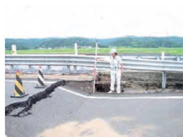
被災直後の状況
