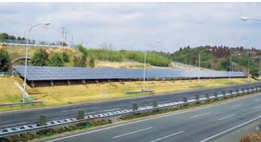
お手洗い照明等に利用している太陽光発電100kW (東関東道 酒々井PA)
