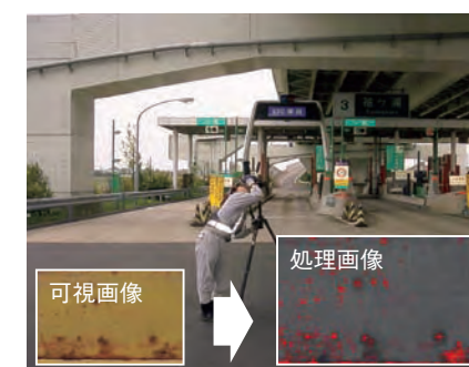
画像処理技術に応用した 塗膜劣化度の調査（ペイントビュー）
