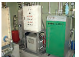
地中熱ヒートポンプ
