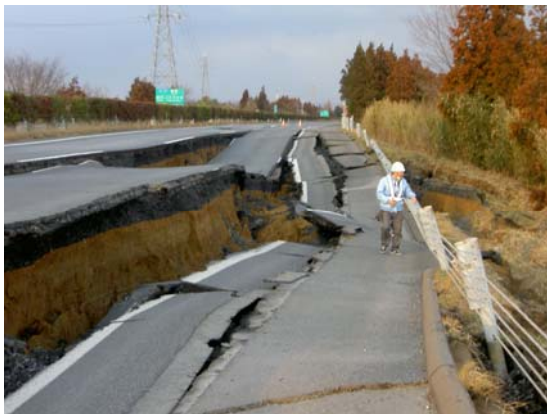
被災後の道路損傷状況 (3月11日)
