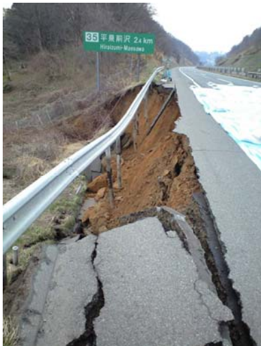
被災後の道路損傷状況 (4月8日)
