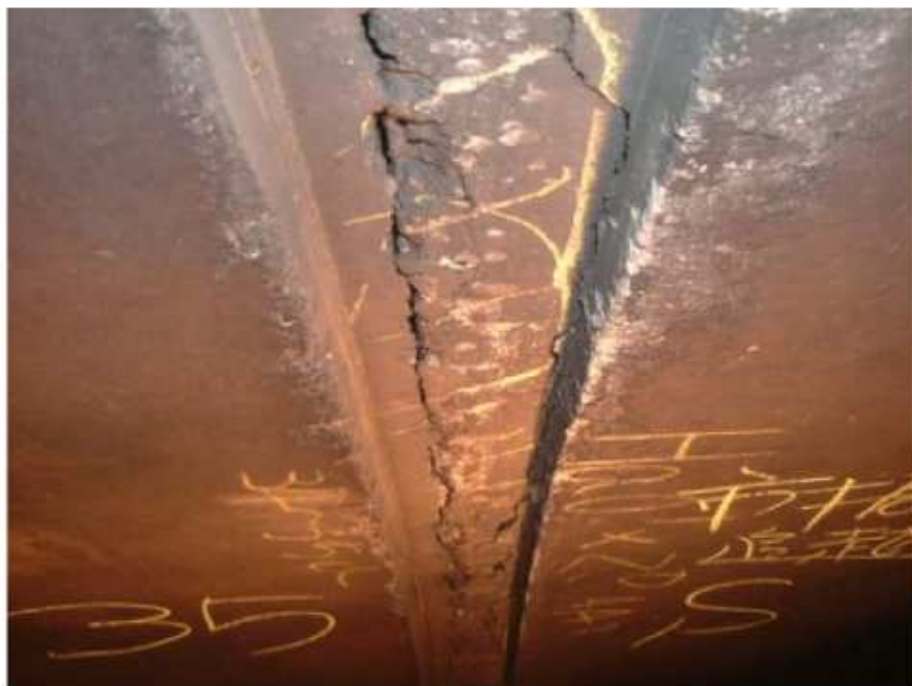
変状状況(目地部はく離)
