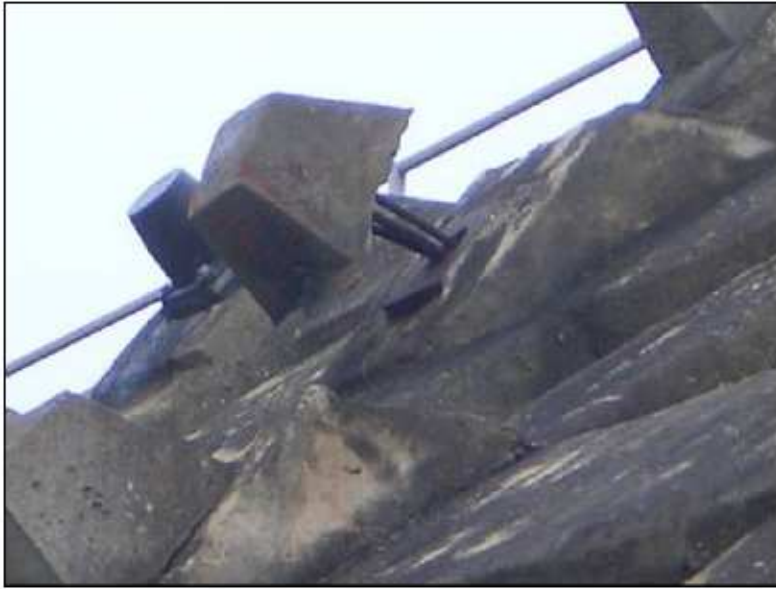
アンカー頭部の腐食・破損
