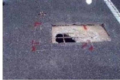
中空床版等の路面陥没等
