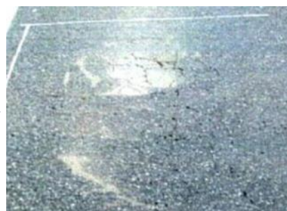
舗装路面のひび割れの発生状況
