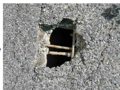
路面の陥没事象
