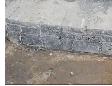
舗装路盤部の疲労破壊
