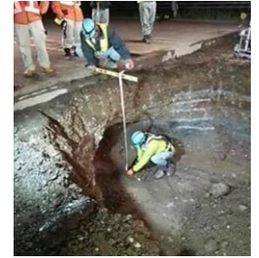
火山堆積物地質における路面陥没
