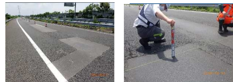
補修箇所も含め、わだち掘れが進行
