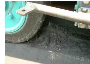
床版防水グレードⅠ 施工中の負荷により性能低下
