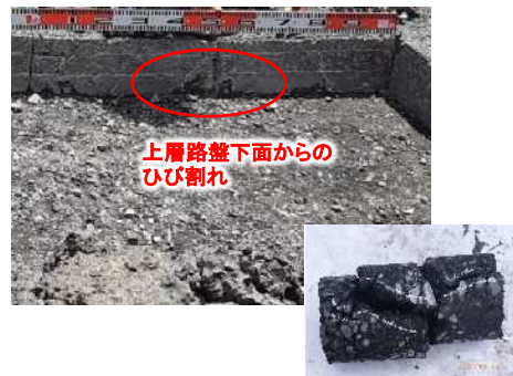
開削調査にて上層路盤までのクラック確認
