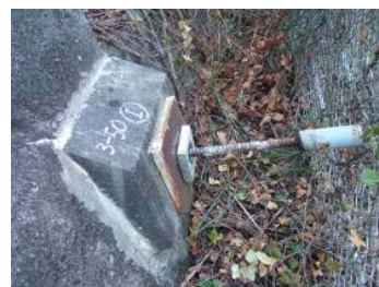
図 4.4.10 旧タイプグラウンドアンカーの劣化
