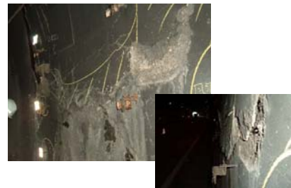
(トンネル覆工の変状状況)
