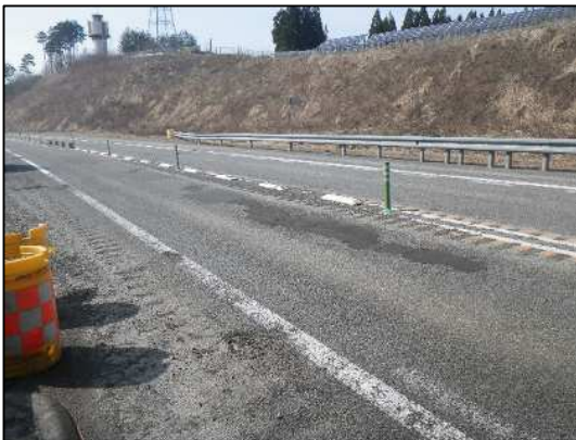
舗装損傷写真
