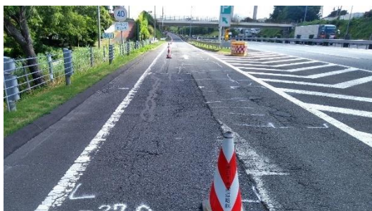
舗装損傷状況
