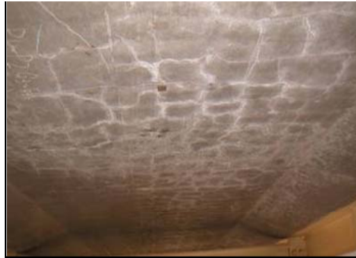
床版の疲労劣化
