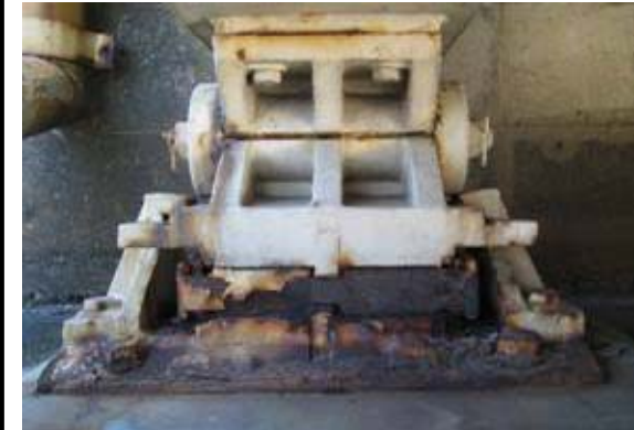
漏水による支承の劣化
