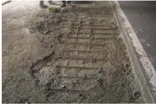
床版上面の劣化
