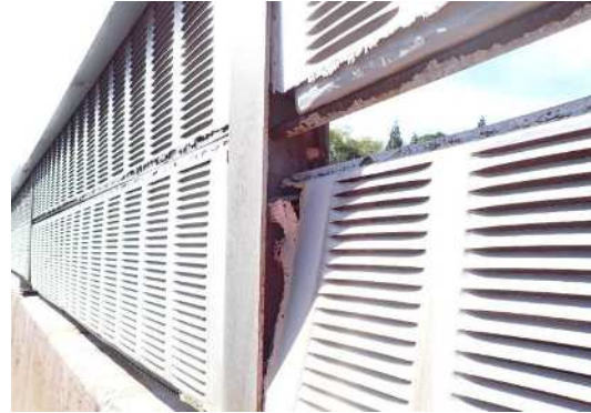
遮音壁損傷写真(拡大)
