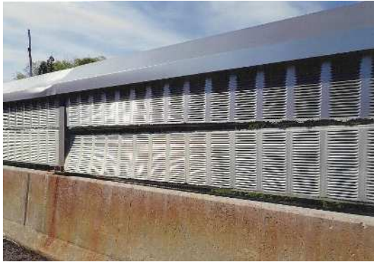
遮音壁損傷写真
