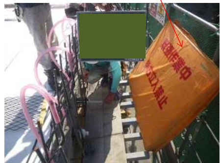
緊張状況(固定側)
