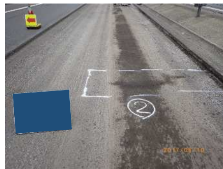
施工前（ひび割れ状況）
