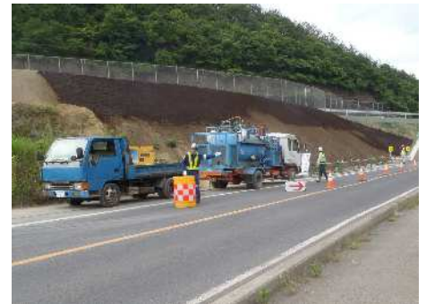
【参考】種吹付設備
