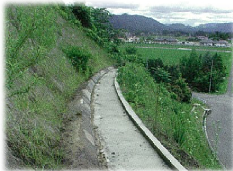
自然環境に配慮した小段排水
