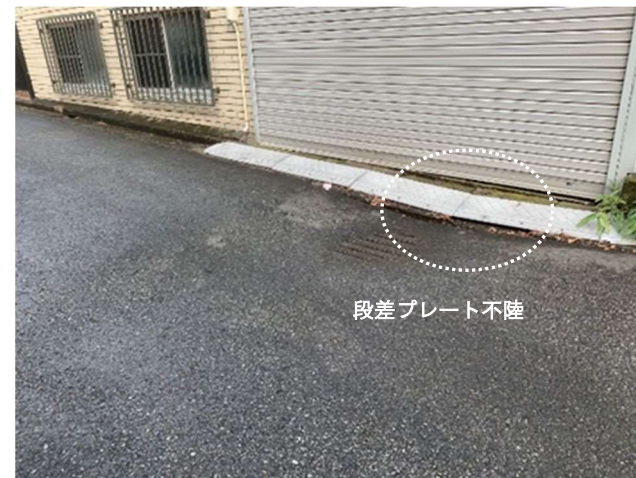
写真 3 陥没箇所（2020 年 10 月 18 日 9:30 撮影）
