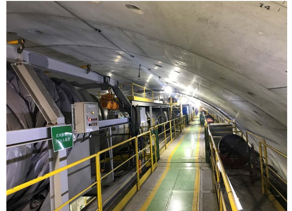
写真3 坑内状況写真(陥没位置付近右側)
