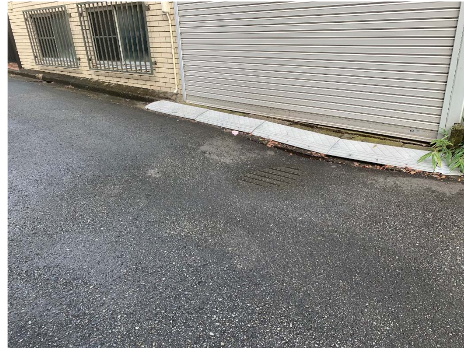
写真2 陥没箇所(2020年10月18日_9:30水たまり)
