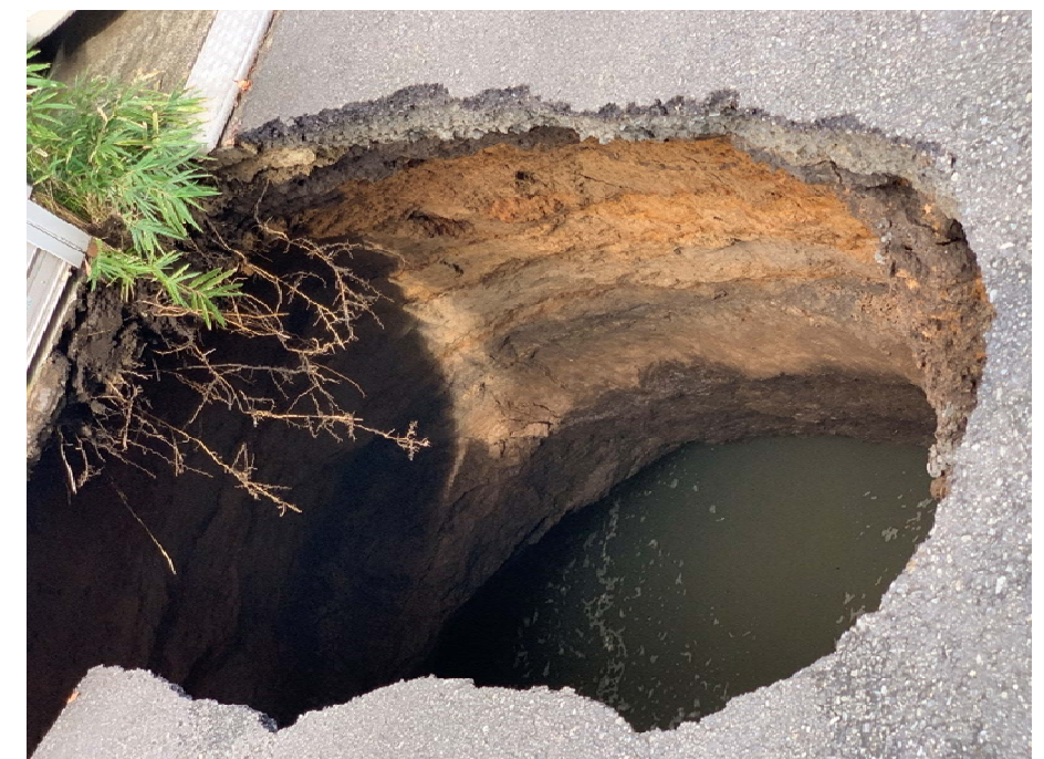
写真6 陥没箇所(2020年10月18日_13:00_西側から撮影)
