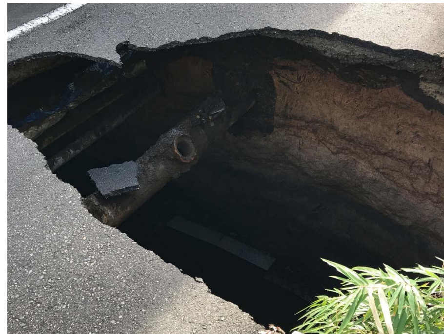
写真5 陥没箇所(2020年10月18日_13:00_東側から撮影)
