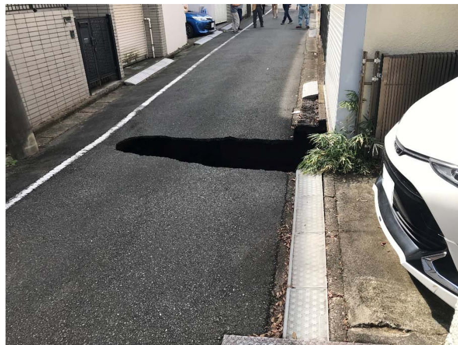
写真4 陥没箇所(2020年10月18日_12:30)
