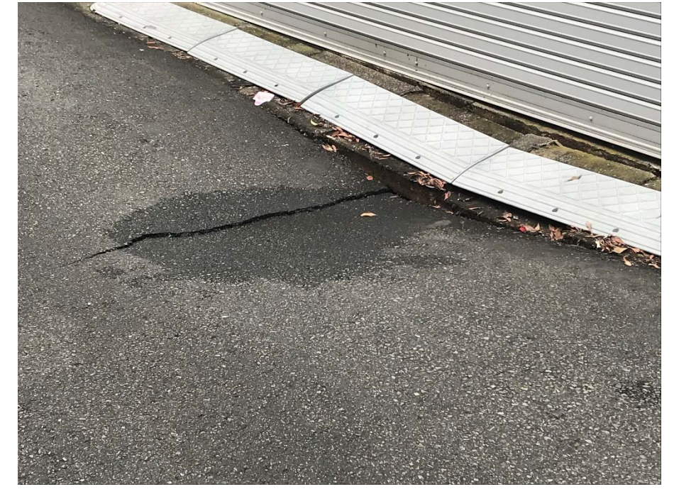
写真3 陥没箇所(2020年10月18日_11:50_舗装亀裂)
