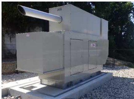
【自家発電設備整備状況】
