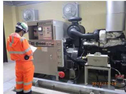
【自家発電設備の点検（施設）】
