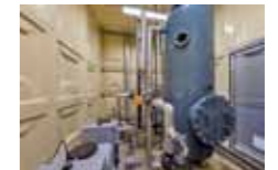
断水時に備えた井戸の設置
