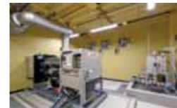
停電時に備えた自家発電設備の設置
