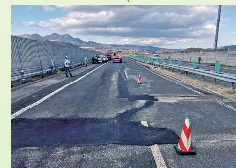
2022年3月17日 応急復旧後の状況 (発災16時間後 通行止め解除)
