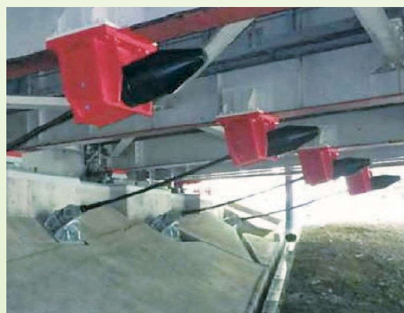
落橋防止装置の設置例
