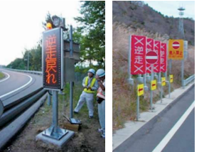
逆走防止装置と逆走防止標識
