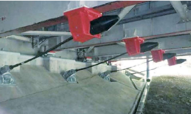
落橋防止装置（一例）
