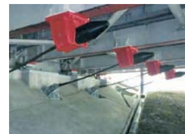
落橋防止装置（一例）
