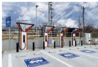
EV急速充電器（常磐道 千代田PA上り線）
