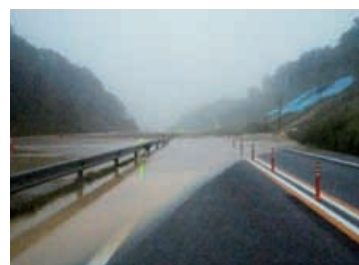
雨によるのり面の崩落
